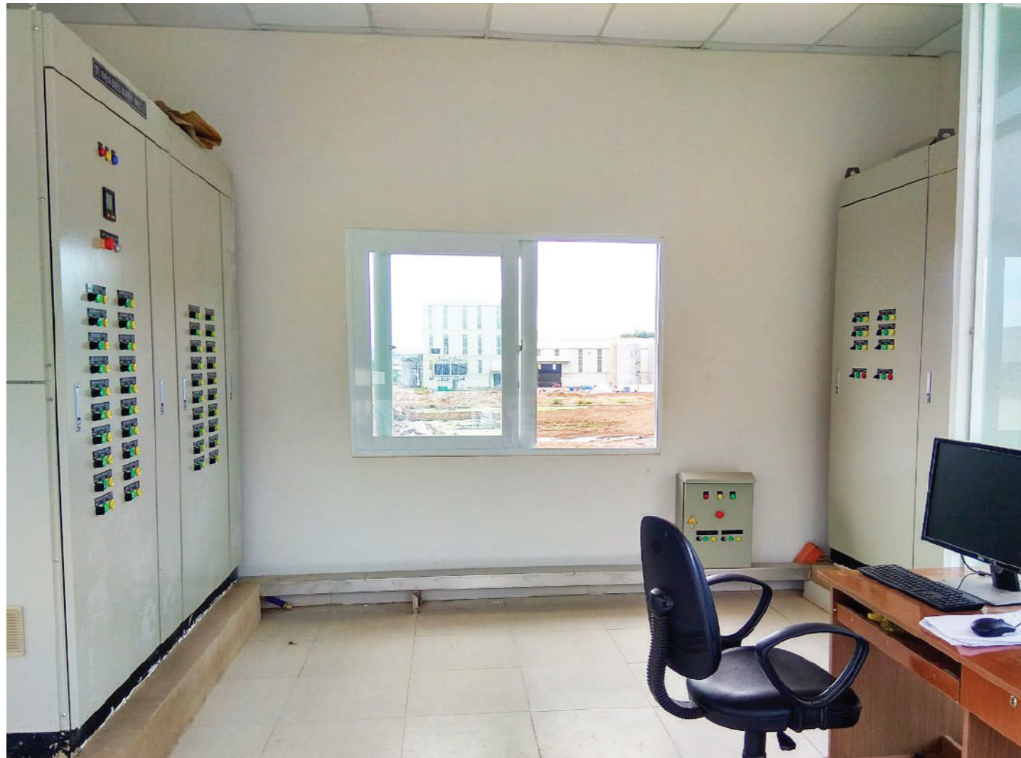
▶ Cung cấp & Lắp đặt hệ thống điều khiển tự động hoá PLC-SCADA cho Trạm xử lý nước thải nhà máy FSC
