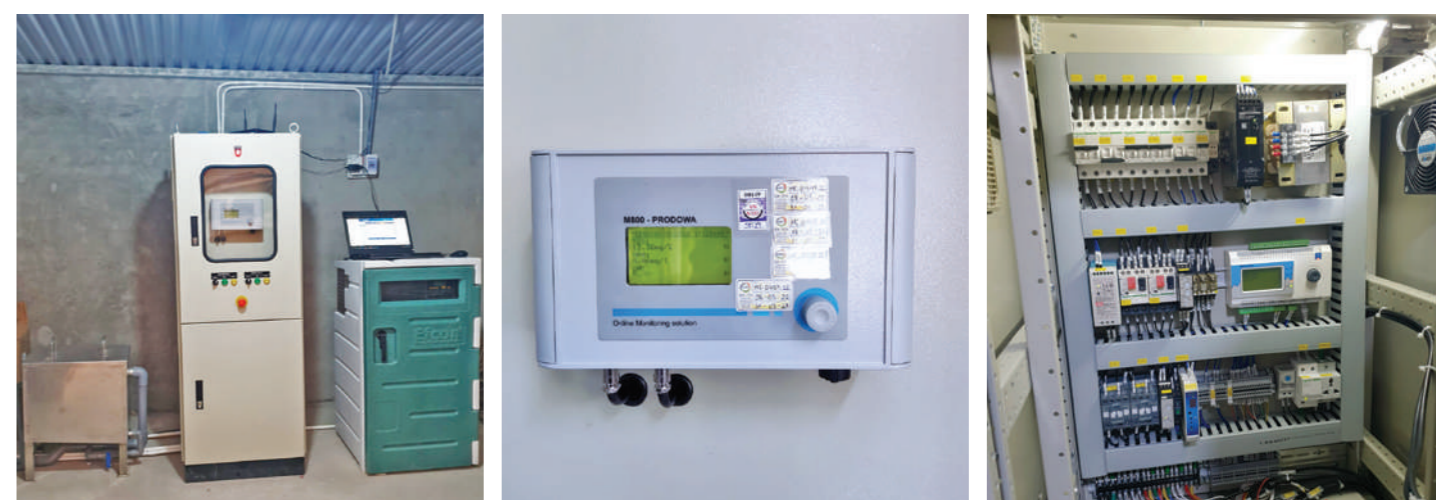
Hệ thống quan trắc nước thải tự động tại Trạm xử lý nước thải KCN Đồng Xoài III
